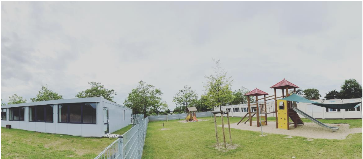
(Juli 2021: Bauphase des neuen Moduls. Der Zaun wird noch verlegt. Beide Module werden durch das gemeinsame Außengelände verbunden)
