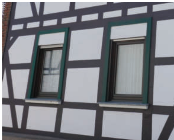
Abb. 51.2 - 51.3 relativ unauffälliger Rollladeneinbau
