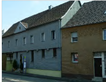
Abb. 53: unpassende Materialverwendung / Fassadenverblendung (Kuchenheimer Str.) Quelle: Eigene Fotografie 2015
